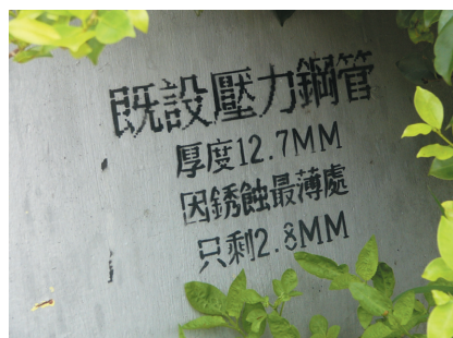
写真-7 年月の長さを感じさせる配水管の厚み表示
