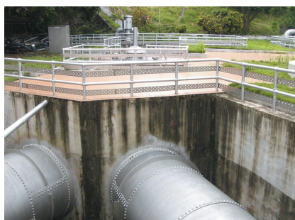
写真-6 設置当時と変わることなく水を送る配水管
