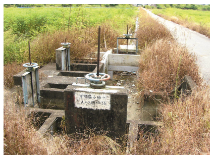
写真-16 各小区への分水堰
